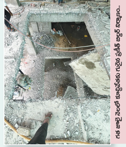
గత జూలై నెలలో కూల్చివేతకు గురైన ప్రణీత బల్డర్ నిర్మాణం..
