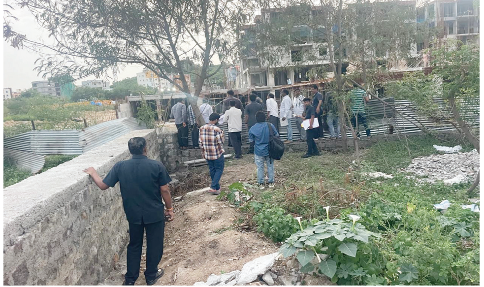
వర్షాకాలంలో ఇలా మునిగిపోయిన మన్ భూమ్ నిర్మాణం. ఫైల్ ఫోటో
